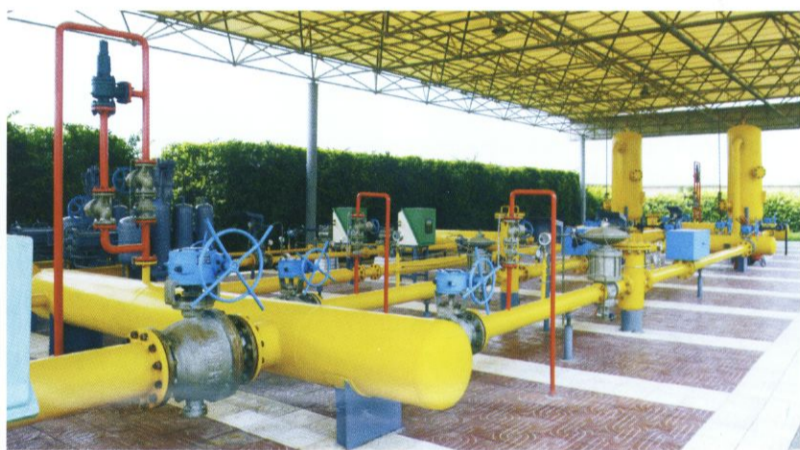
采取多种措施确保安全运行
