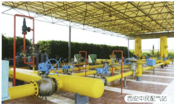
西安中民配气站
